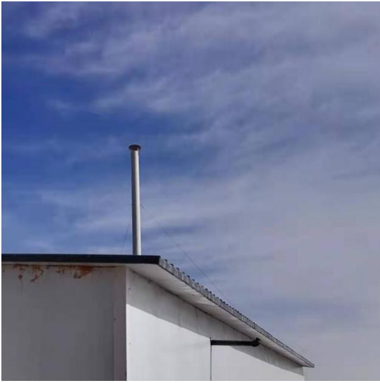
热风炉排气筒
