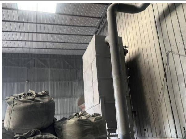
布袋除尘器（分段筛（二部分）+雷蒙磨粉尘）
