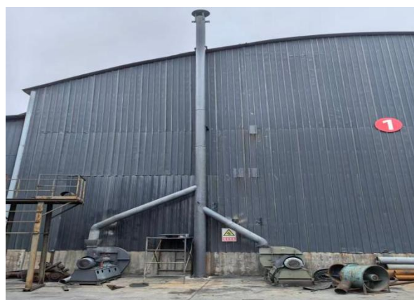
气流磨排气筒 (DA002)
